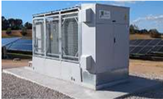
Exemple de Centre de Transformació 25 / 0,8 kV de 1,8 MVA de potència
