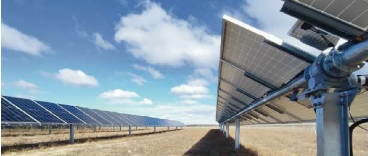
Exemple d'estructura de panells fotovoltaics amb seguidor
